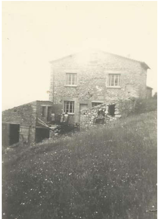
La maison de Pallaire plus tard, après transformation du galetas en chambre. A l'époque de Marcelle, il n'y avait qu'une seule petite fenêtre à l'étage.
